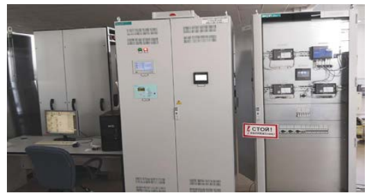
Рис. 7. Шкафы инвертора, АСУ и АРМ макета СЭС
